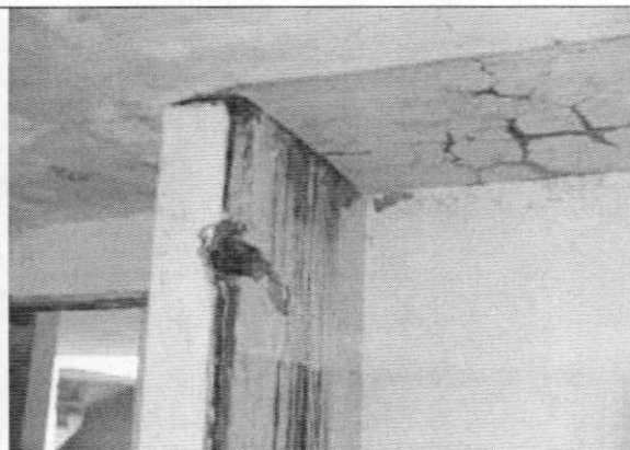
Foto 8. Placa agrietada cuarto piso
