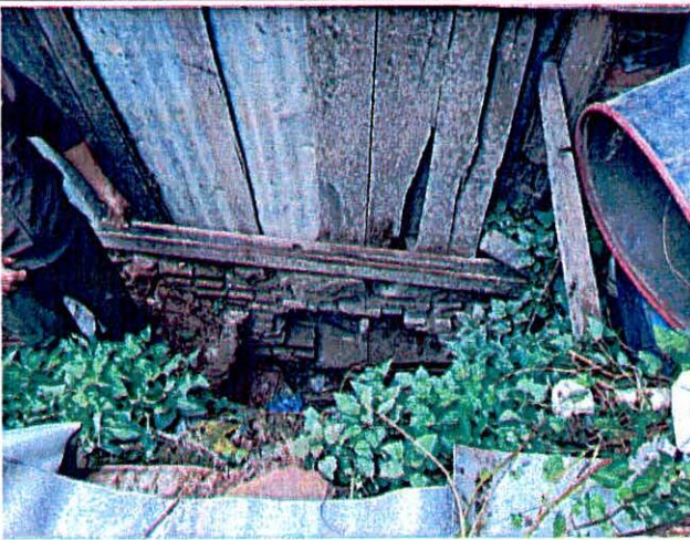
Fotografía 5. Pérdida de mampuestos en parte inferior de muro de cerramiento, zona de patio.
