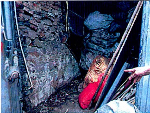
Fotografía 3. Filtración de agua y humedad en muro perimetral costado sur, zona de depósito primer nivel.
