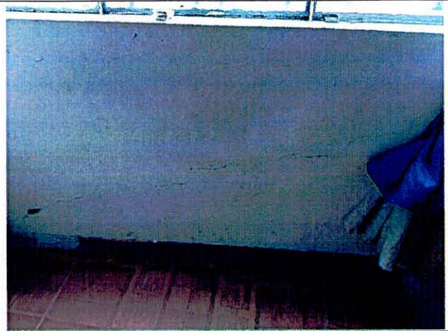
Fotografía 4. Fisura en muro perimetral oriental, segundo nivel.
