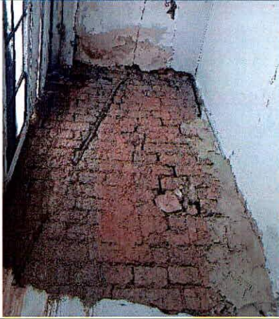
Fotografía 7. Desprendimiento de acabados en el muro perimetral del costado sur en zonas comunes
