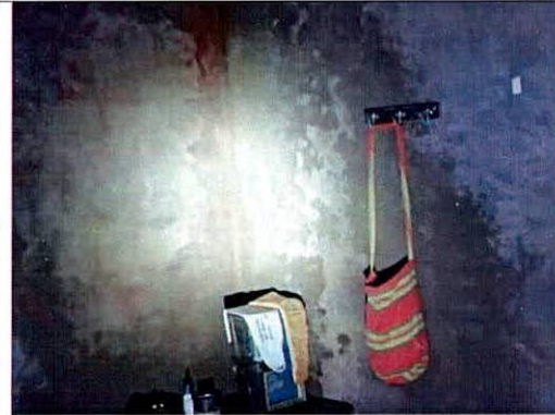
Fotografía 4. Humedad costado posterior de la vivienda.
