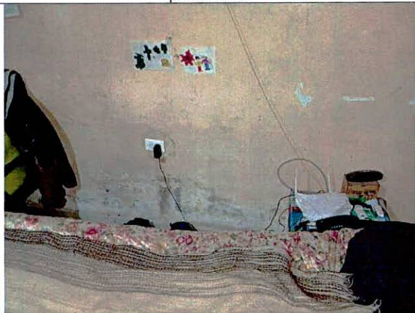
Fotografía 5. Humedades en muro perimetral oriental, primer nivel.
