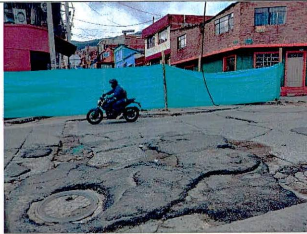
Fotografía 8. Deterioro general avanzado de la vía de la KR 4 Este a la altura de la CL 31 Sur.
