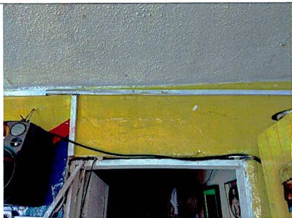
Fotografía 3. Fisura de tendencia horizontal en muro divisorio, primer nivel.
