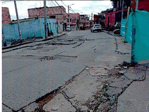
Fotografía 6. Estado general de la vía de la KR 4 Este a la altura de la CL 31 Sur.
