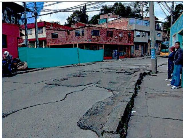
Fotografía 7. Fisuras, grietas, hundimientos y baches sobre la vía.
