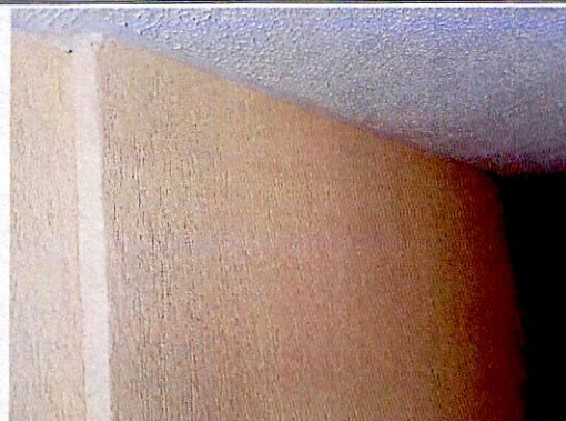
Fotografía No. 6. Vista general de grieta horizontal en pasillos del interior 5- 3 nivel.
