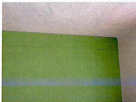
Fotografía No. 2. Vista general de grietas horizontales en muros de la vivienda del apto 401.
