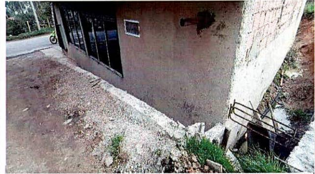
Fotografía No. 4. Vista lateral y posterior de la edificación. Empozamiento de aguas lluvias.
