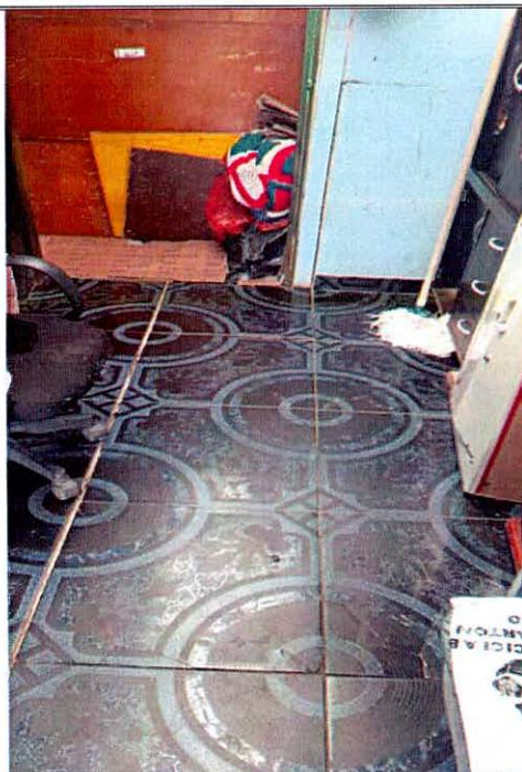
Fotografía 11. Losetas de piso de la vivienda del predio de la KR 13 B ESTE 89 99 SUR, sueltas y rotas.
