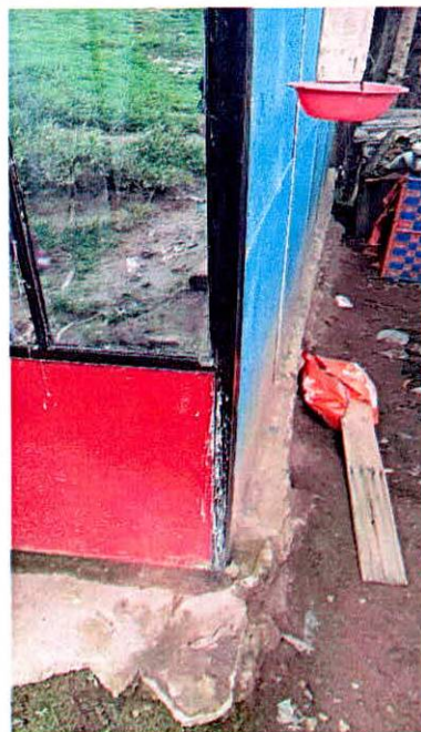
Fotografía 10. Separaciones entre paneles de concreto de la vivienda del predio de la KR 13 B ESTE 89 99 SUR.
