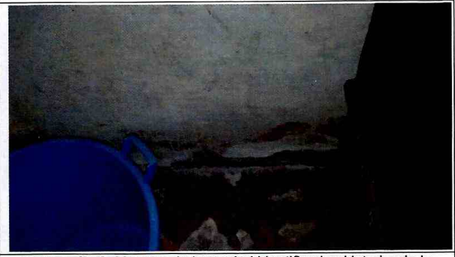
Fotografía 6. Muestra de humedad identificada al interior de la edificación evaluada
