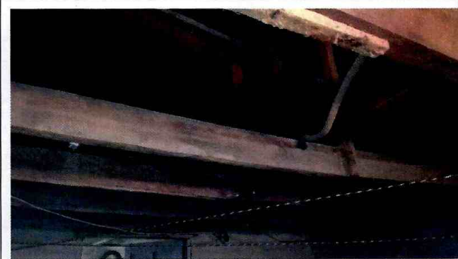
Fotografía 10. Elementos de madera "tipo cercha" que soportan la cubierta en zona habitacional, costado occidental de la edificación evaluada
