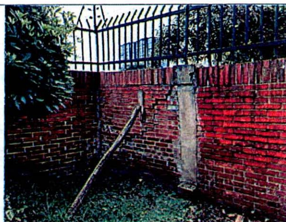
Fotografía 16. Grieta de tendencia diagonal en muro de cerramiento del costado oriental del predio
