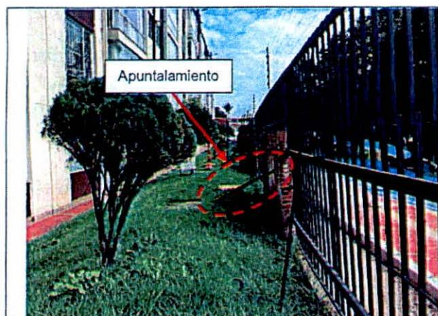
Fotografía 15. Pérdida de verticalidad y apuntalamiento en muro de cerramiento del costado oriental del predio
