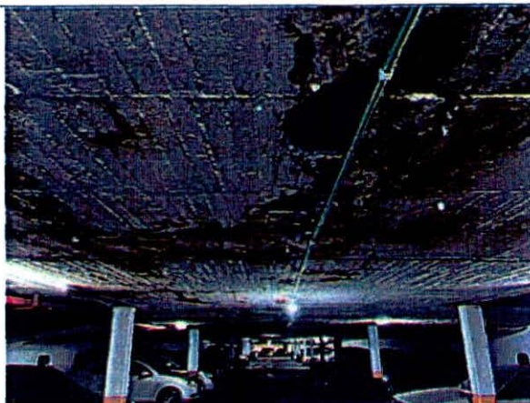
Fotografía 10. Daños en la torta inferior de la losa aligerada de la plataforma de parqueaderos
