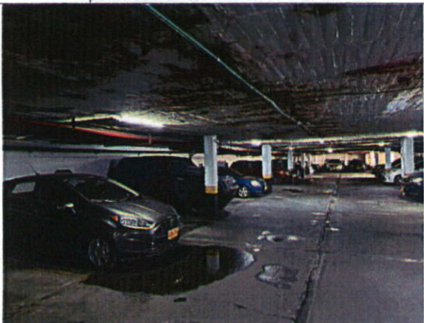
Fotografía 11. Humedad y filtración en la torta inferior de la losa aligerada de la plataforma de parqueaderos
