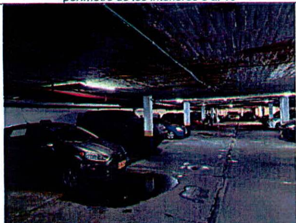
Fotografía 11. Humedad y filtración en la torta inferior de la losa aligerada de la plataforma de parqueaderos
