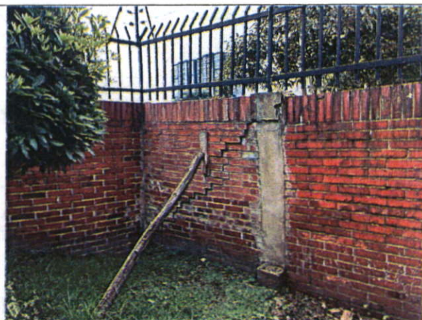
Fotografía 16. Grieta de tendencia diagonal en muro de cerramiento del costado oriental del predio
