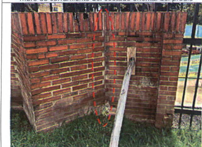
Fotografía 17. Grieta de tendencia vertical en unión entre muros de cerramiento del costado oriental del predio
