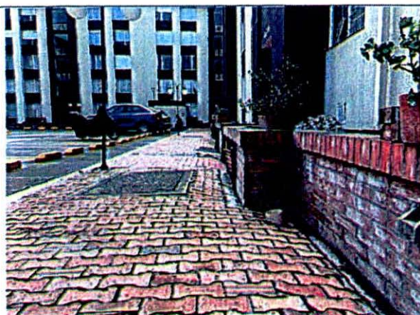
Fotografía 9. Deformaciones del sendero peatonal en el perímetro de los interiores 8 al 13
