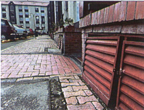
Fotografía 8. Deformaciones del sendero peatonal en el perímetro de los interiores 8 al 13
