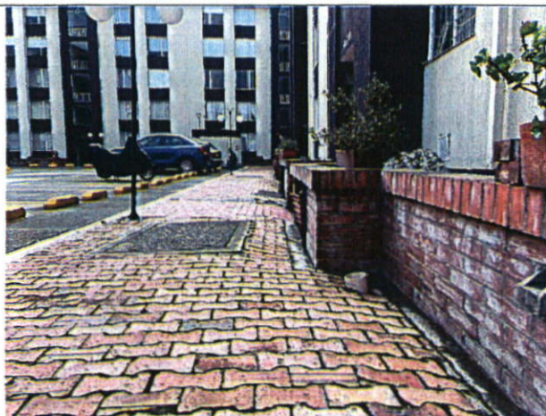
Fotografía 9. Deformaciones del sendero peatonal en el perímetro de los interiores 8 al 13
