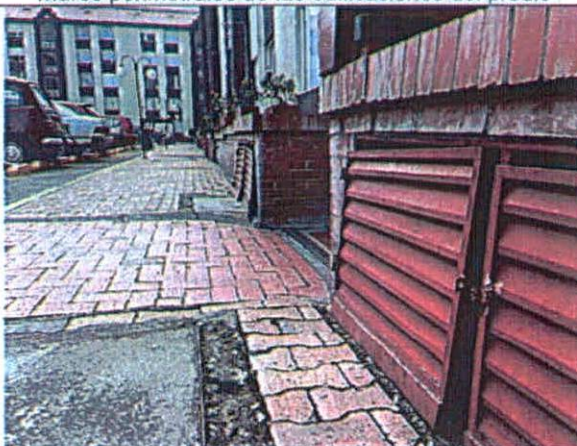
Fotografía 8. Deformaciones del sendero peatonal en el perímetro de los interiores 8 al 13
