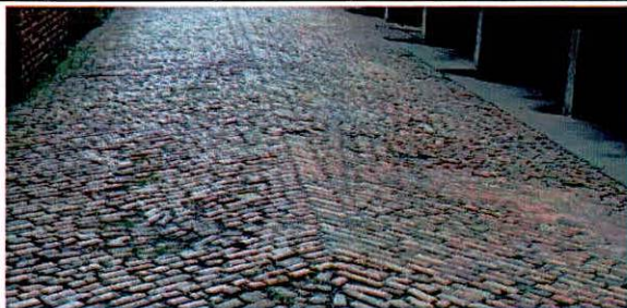
Fotografía 5. Vista general del hundimiento del ingreso a parqueaderos y ausencia de mampuestos
