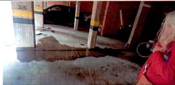
Fotografía 6. Placa de parqueadero con lámina de agua.
