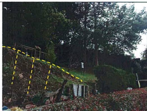
Fotografía 3. Condiciones identificadas en P2 – Desprendimientos locales de terreno (27 de febrero de 2024).
