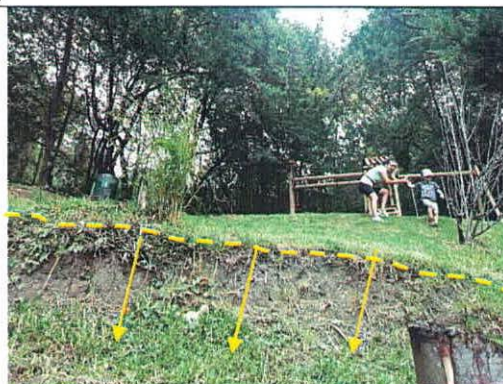
Fotografía 5. Condiciones identificadas en la visita realizada el 27 de febrero de 2024 –Procesos locales de inestabilidad.
