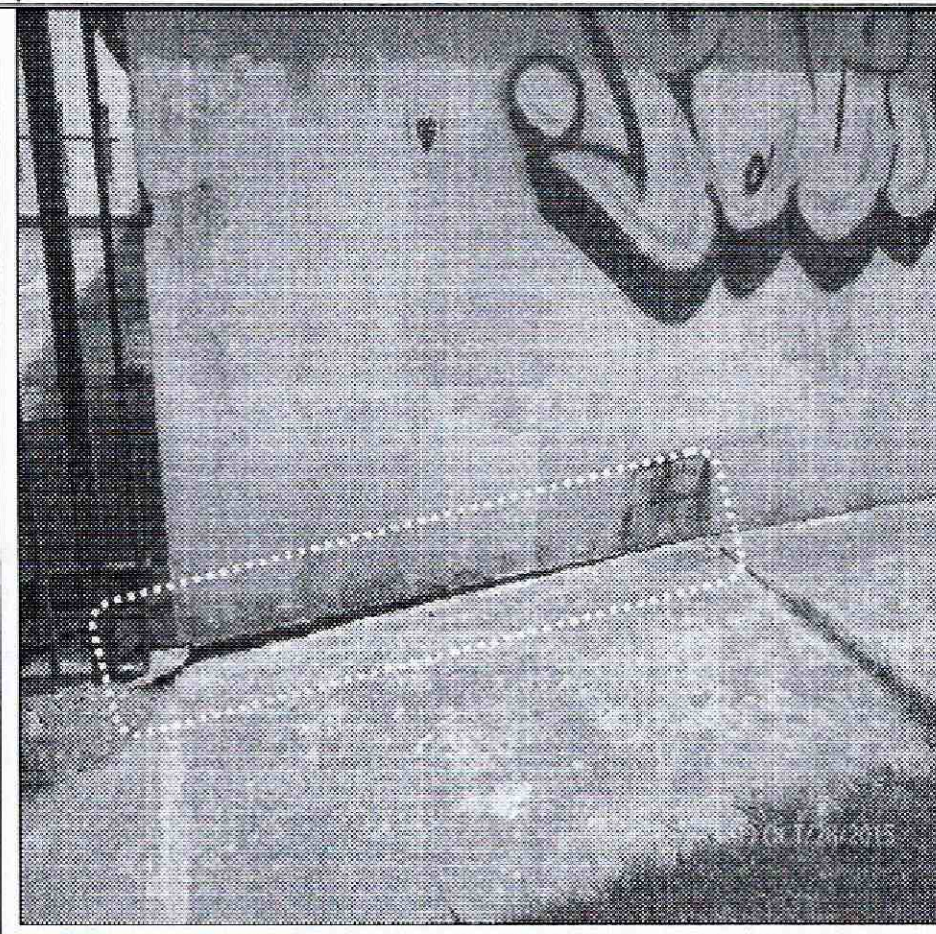
Fotografía 24. Hundimiento identificado en andén peatonal del costado occidental de zona de antejardín de la vivienda ubicada en el predio de la Calle 170 A Bis No. 57-51, en el Sector Catastral Villa del Prado de la Localidad Suba.
