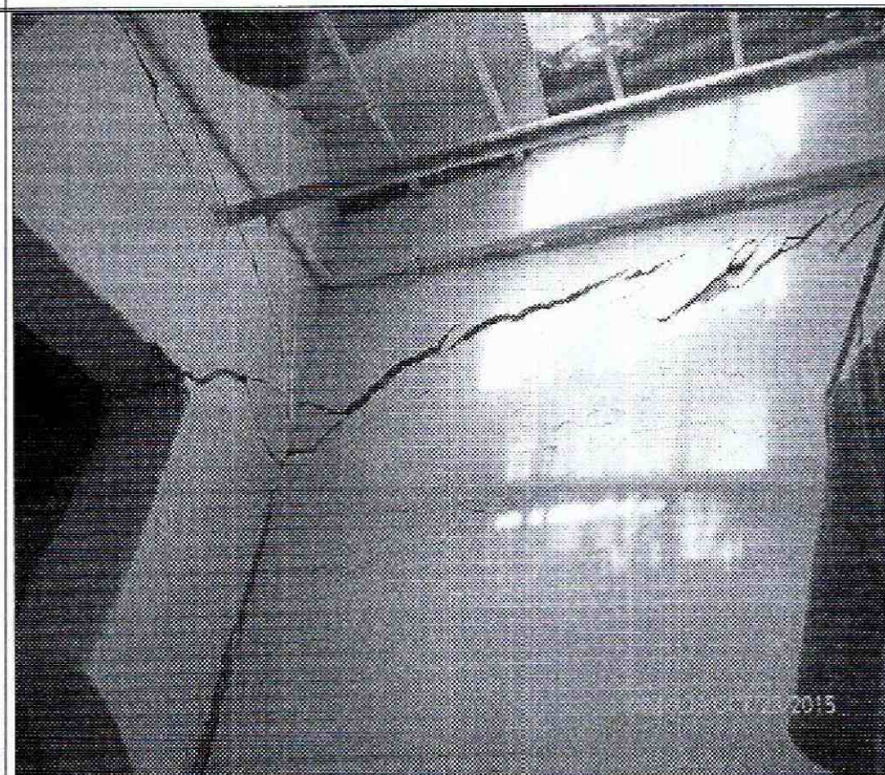
Fotografía 7. Grietas identificadas en zonas de ampliación posterior de las viviendas de la Calle 171 No. 58-25 / 31 / 35 / 41, del polígono evaluado en la Carrera 56 y la Carrera 62, entre la Calle 170 y la Calle 172 A, en el Sector Catastral Villa del Prado de la Localidad Usaquén.
