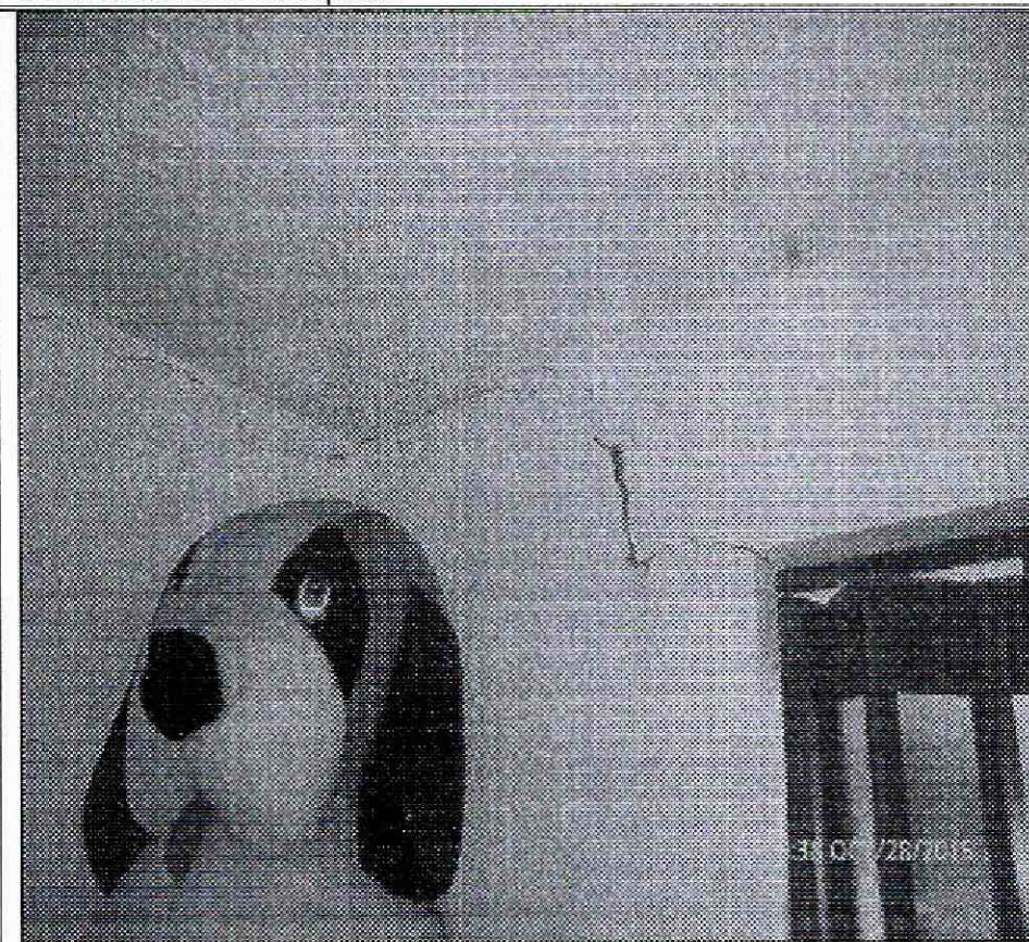
Fotografía 8. Grietas identificadas en zonas de ampliación posterior de las viviendas de la Calle 171 No. 58-25 / 31 / 35 / 41, del polígono evaluado en la Carrera 56 y la Carrera 62, entre la Calle 170 y la Calle 172 A, en el Sector Catastral Villa del Prado de la Localidad Usaquén.
