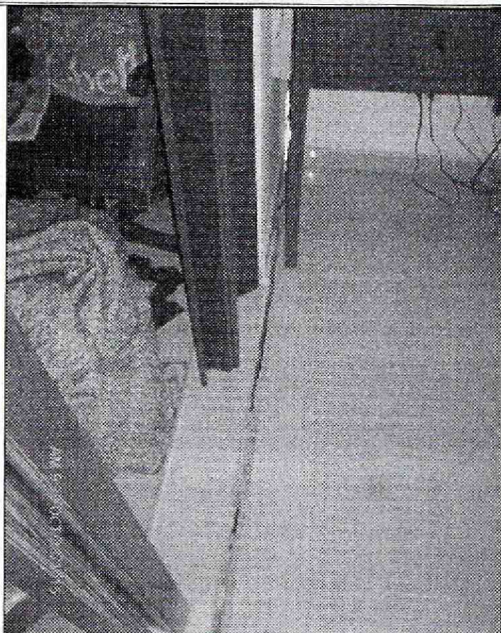
Fotografía 11. Aberturas identificadas en zonas de ampliación posterior de las viviendas de la Calle 171 No. 58-25 / 31 / 35 / 41, del polígono evaluado en la Carrera 56 y la Carrera 62, entre la Calle 170 y la Calle 172 A, en el Sector Catastral Villa del Prado de la Localidad Usaquén.
