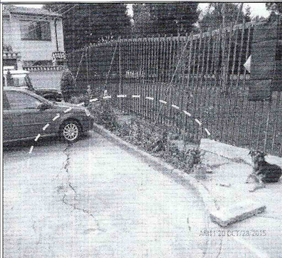
Fotografía 37. Grietas y deformaciones identificadas en vías internas de la zona evaluada en la Calle 170 y la Calle 172 A, entre la Carrera 56 y la Carrera 62, en el Sector Catastral Villa del Prado de la Localidad Suba.
