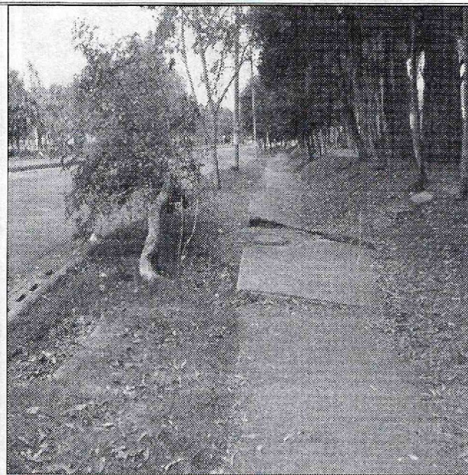
Fotografía 34. Daños en andenes peatonales del sector evaluado de la Carrera 56 y la Carrera 62, entre la Calle 170 y la calle 172 A, en el Sector Catastral Villa del Prado de la Localidad Suba.
