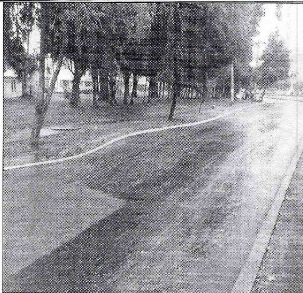
Fotografía 33. Deformaciones en la calzada oriental de la Carrera 58, entre la Calle 170 y la Calle 172 A, en el Sector Catastral Villa del Prado de la Localidad Suba, se observan algunos árboles con pérdida de verticalidad.
