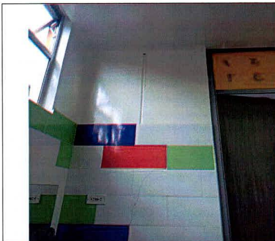
Fotografía 3. Fisuras en junta muro – columna del segundo nivel
