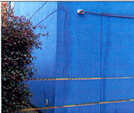
Fotografía 6. Fisuras en muro que atraviesa los tres pisos, adyacente al cuarto eléctrico costado oriental
