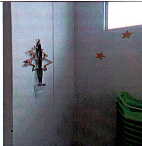
Fotografía 4. Fisuras entre muros internos
