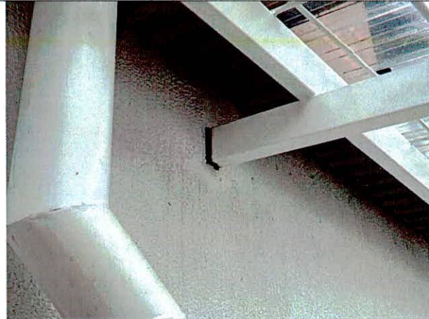
Fotografía 9. Deslizamiento en apoyo de la cubierta del patio del predio P1
