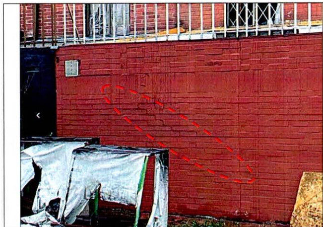
Fotografía 11. Grieta en muro de patio del predio P2
