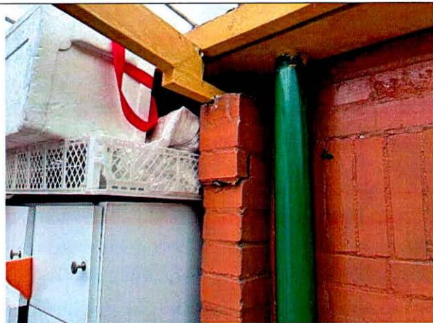
Fotografía 12. Grieta en machón de patio del predio P2
