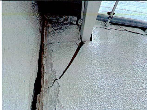
Fotografía 10. Grieta en acabados de muro en patio del predio P1
