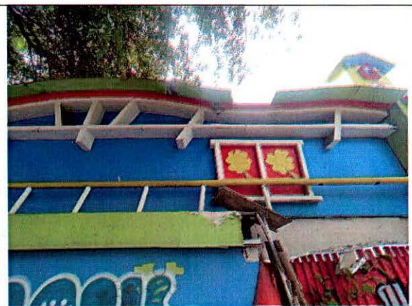
Fotografía 2. Muestra de deterioro y caída de elementos de fachaleta
