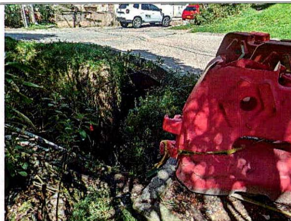
Fotografía No. 6. Vista de la socavación al costado oriental del tramo vial evaluado en P2.
