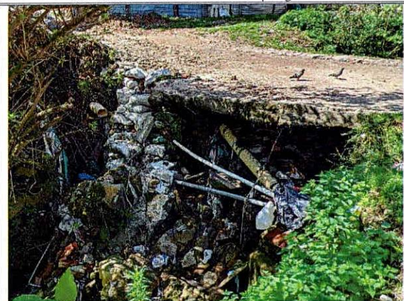
Fotografía No. 3. Vista de la pérdida de soporte de la losa superior del box culvert en P1.
